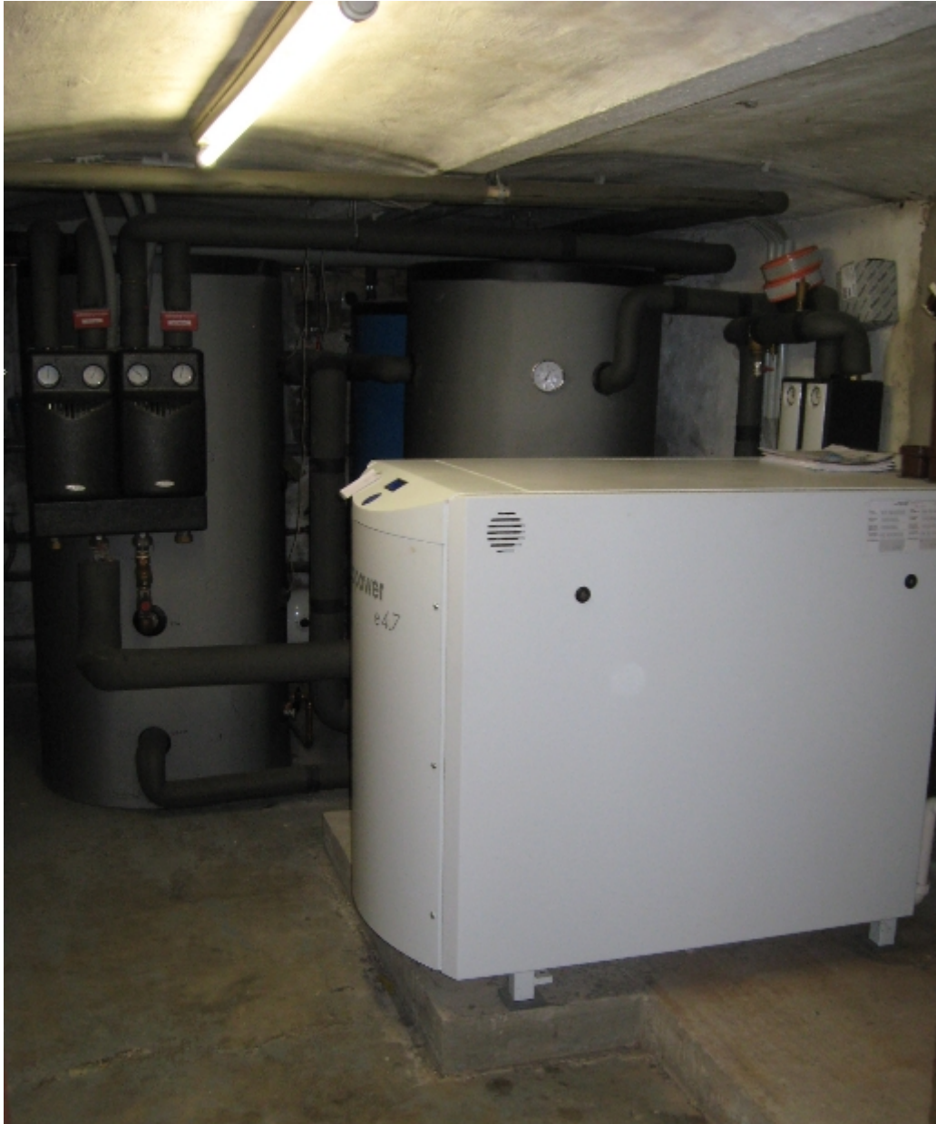
BHKW mit Speichern (hinten)
